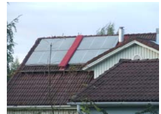
30 pav. Saulės kolektoriai sumontuoti ant stogų pietinių šlaitų.
