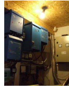
33 pav. Šalia laiptinės įrengta elektrinės valdymo bazė.
